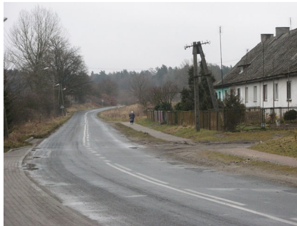
Aktualny stan techniczny ciągów pieszych – widoczne nieciągłości i fragmenty do modernizacji
